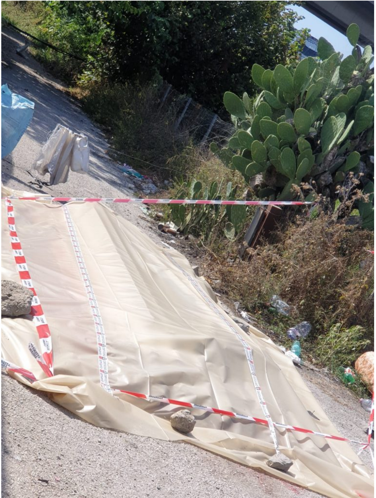
Intervento comune di Nocera Inferiore – Settore Ambiente
