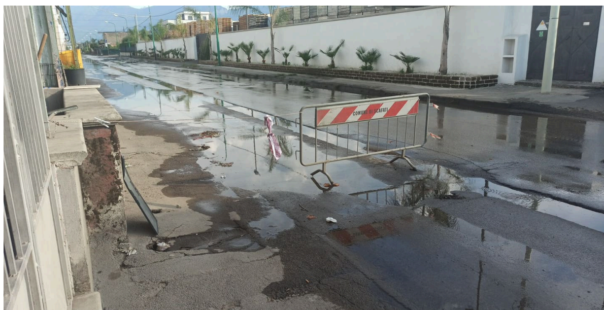
Strada allagata in Via Nuova San Marzano e Via Lo Porto in Scafati (Sa)
