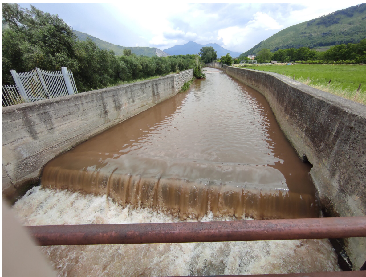
Torrente Solofrana in Mercato San Severino nella frazione di Sant'Eustacchio al confine con Castel San Giorgio
