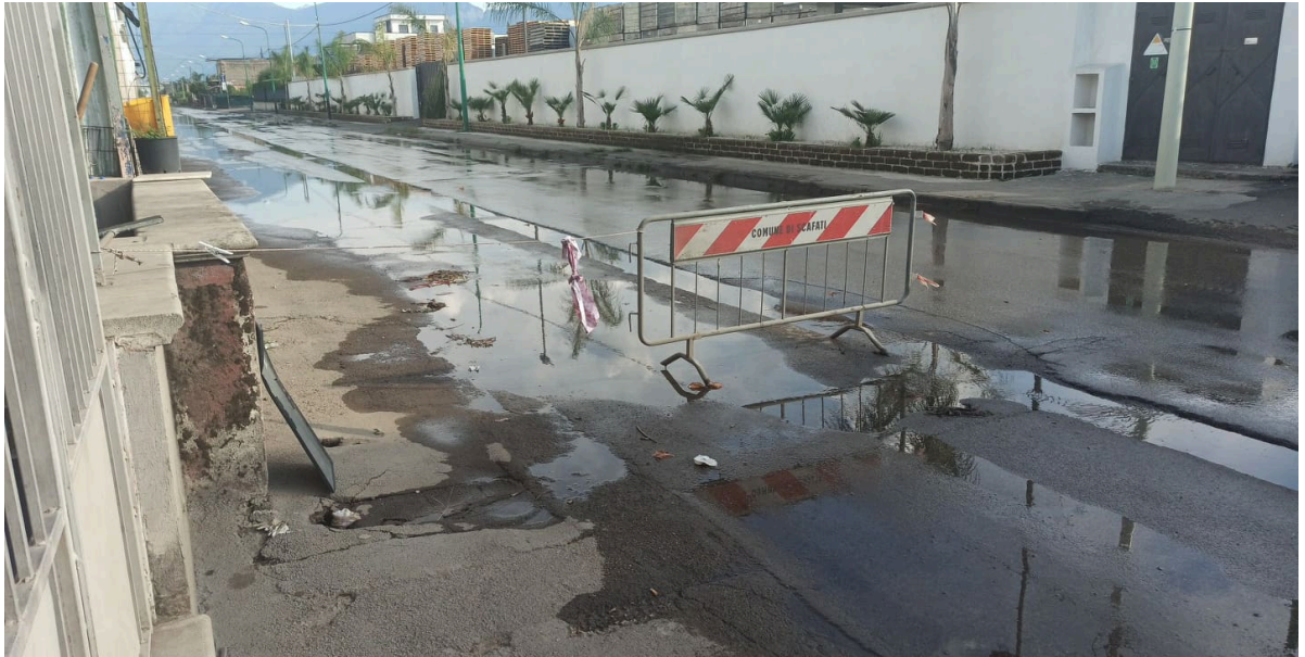
Strada allagata in Via Nuova San Marzano e Via Lo Porto in Scafati (Sa)
