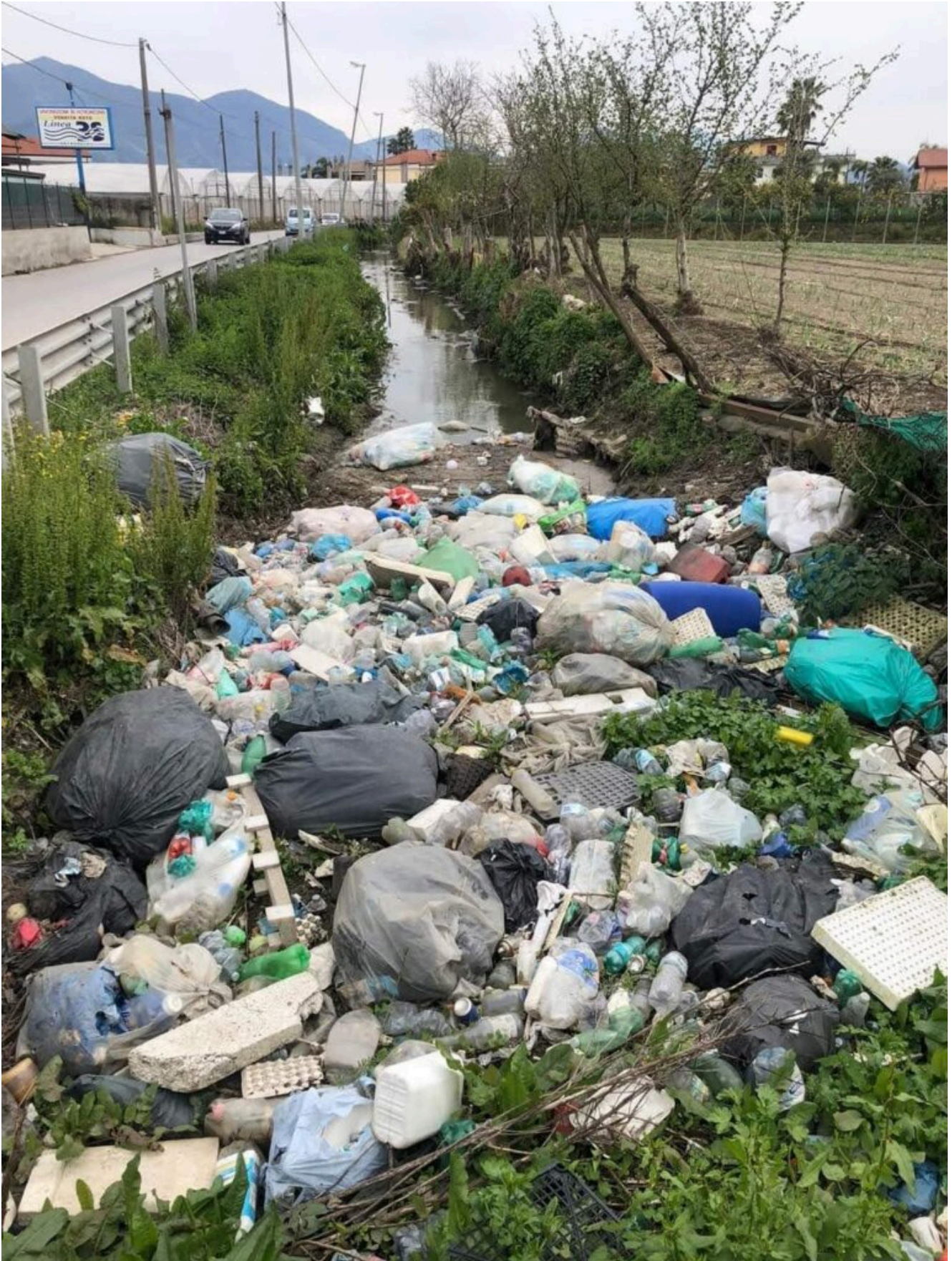
Rifiuti abbandonati nel controfosso destro del Fiume Sarno in Scafati
