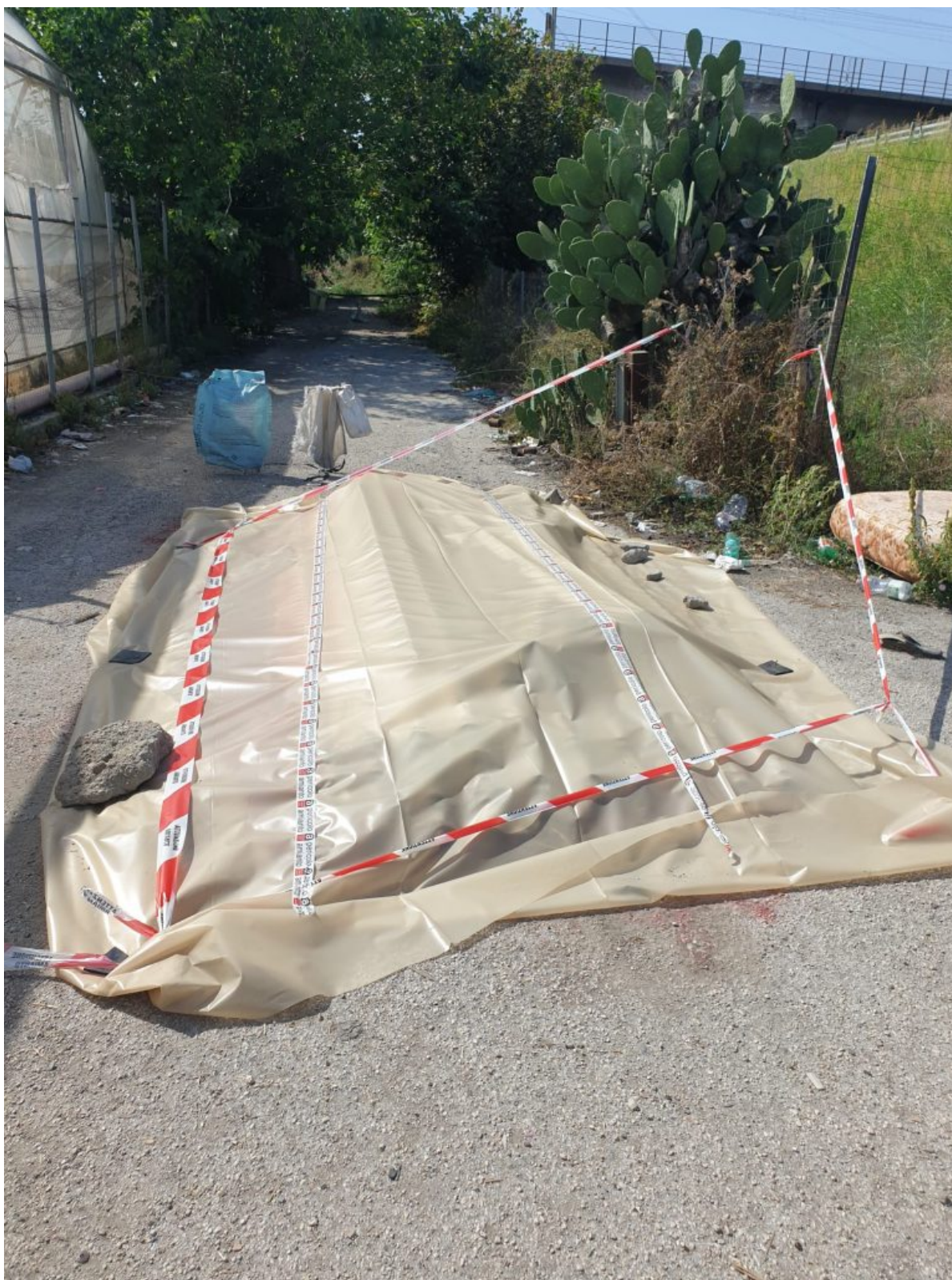
Intervento comune di Nocera Inferiore – Settore Ambiente
