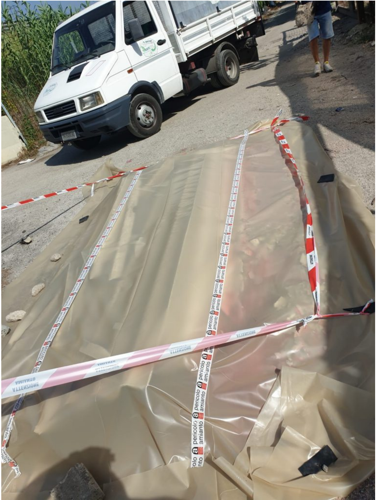
Intervento comune di Nocera Inferiore – Settore Ambiente
